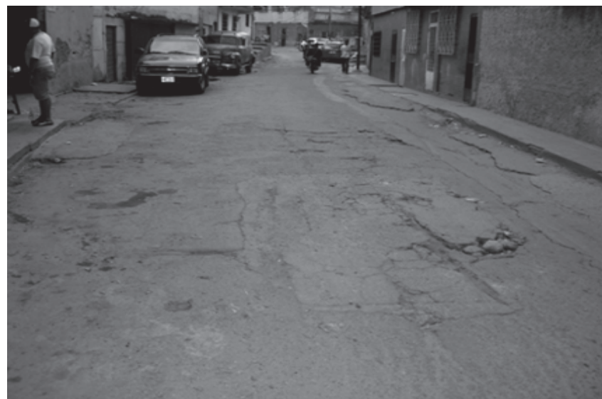
Sector El Carmen (Matadero) las casas tienen filtraciones producto del las condiciones de la calle
